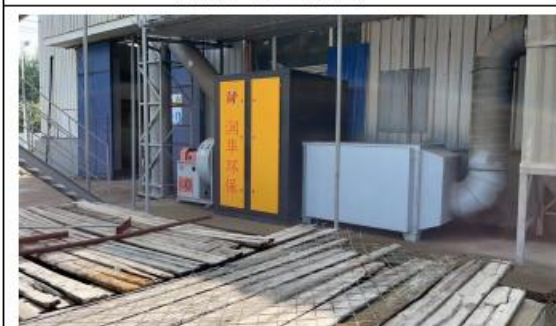
废气治理设施
